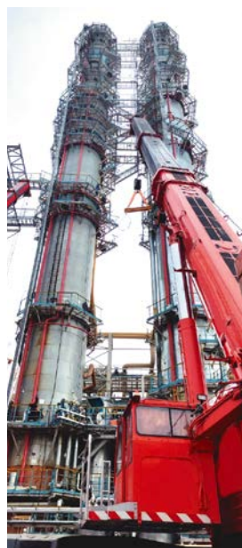
Выполнение ремонтных работ на установках «Пиролиз», ГФ-2, «ДБО» для нужд ООО «ЗапСибНефтехим» (г. Тобольск)
