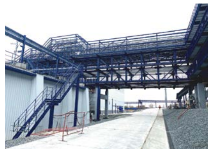
Строительно-монтажные и пусконаладочные работы по объекту «Очистные сооружения АО «Газпромнефть-ОНПЗ» (блок обработки осадка и нефтешлама, сети внутриплощадочные)» (г. Омск)
