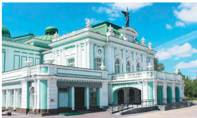
Работы по вертикальной и горизонтальной гидроизоляции фундамента на объекте культурного наследия БУК «Омский государственный академический театр драмы»
